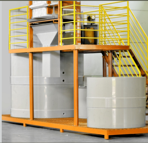
Tanques para tratamento de efluentes
